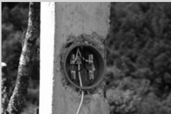
Y a pesar de que la infraestructura no destaca por su calidad...
